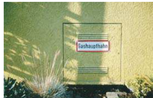
Außen liegender Hausanschluss
